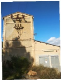
POSIZIONAMENTO CABINA ENEL
